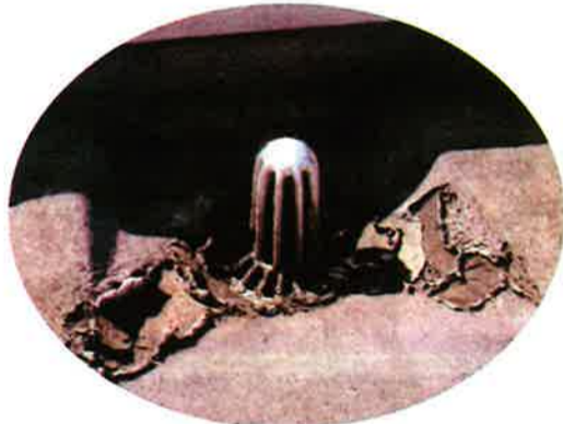
塗装のカーリング現象（14号棟屋上）
