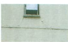
浴室から外壁への漏水
