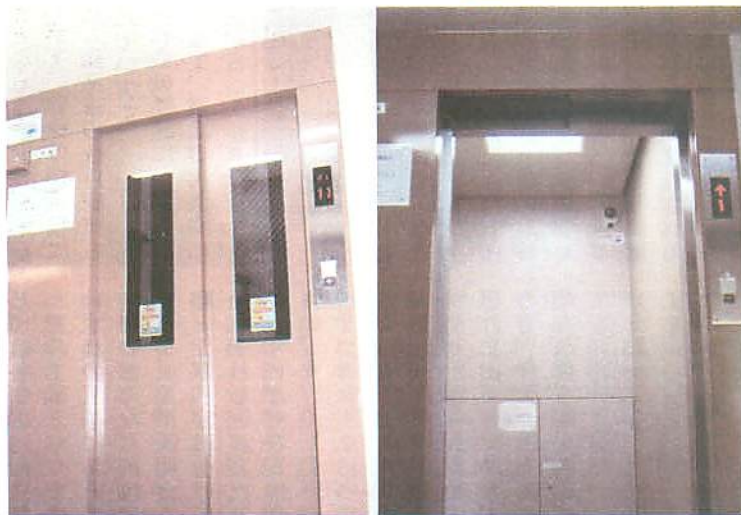
更新された29号棟エレベーター
