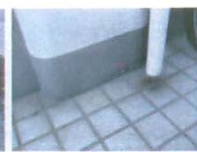
モルタル浮き 塗装はがれ
